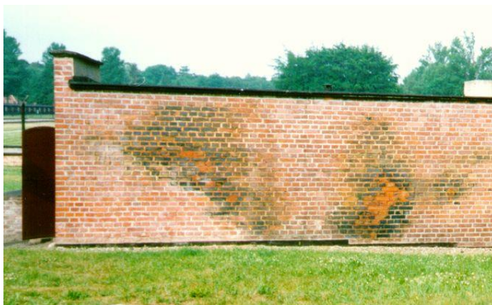
Ook hier: Pruisisch Blauw dwars door muren van de ontluizingsruimte.
