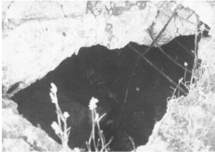
Foto van gat in dak overblijfselen lijkenkelder Krema II, op ruwe wijze na de oorlog daarin aangebracht (let ook op het opzij gebogen betonijzer).
