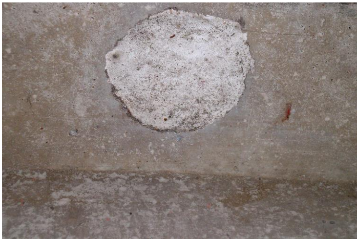
Voorbeeld van een later gedicht gat in een willekeurig betonnen plafond.
